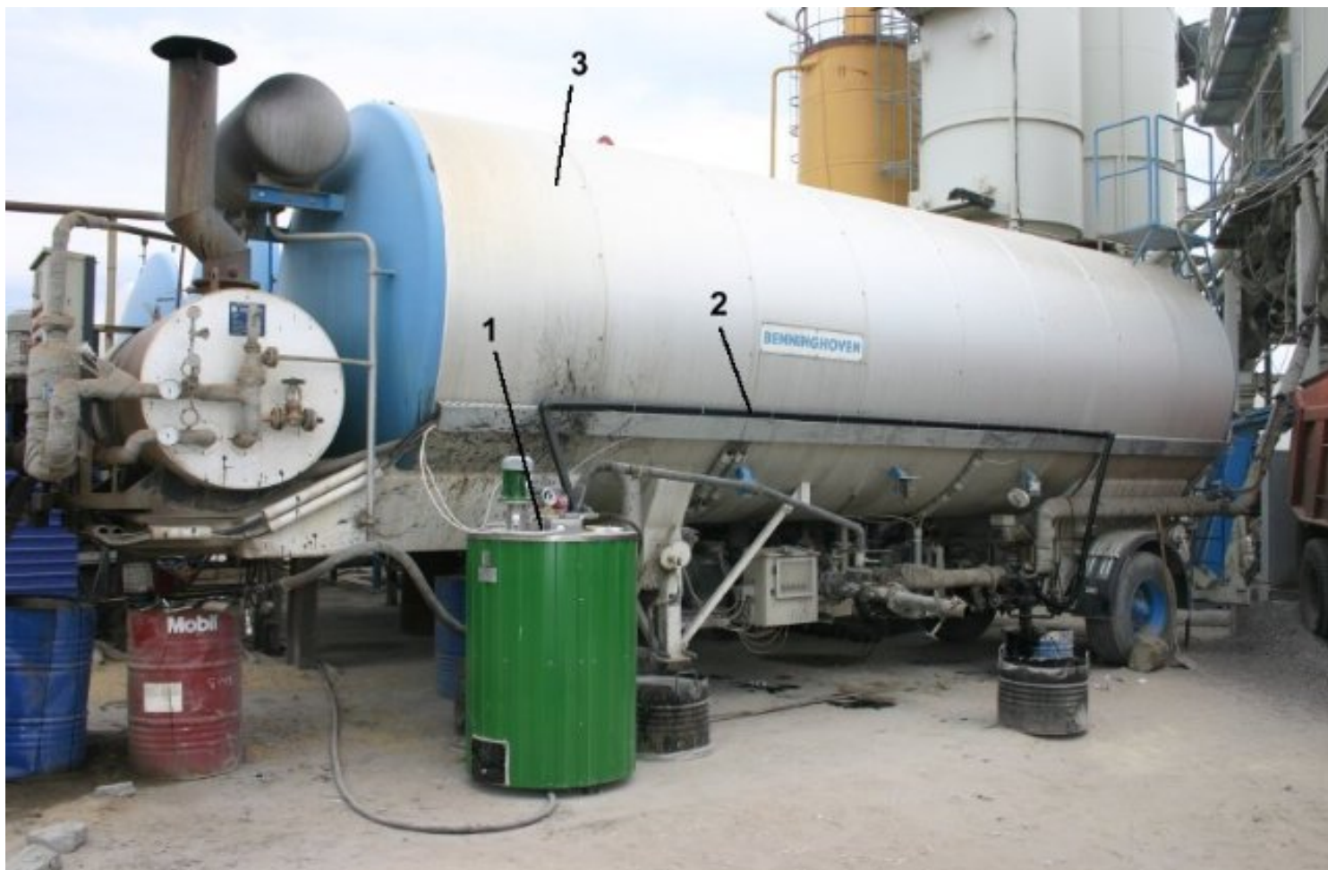
Рис. 3. Линия ввода адгезионной добавки, смонтированная на мобильном АБЗ Benninghoven.
